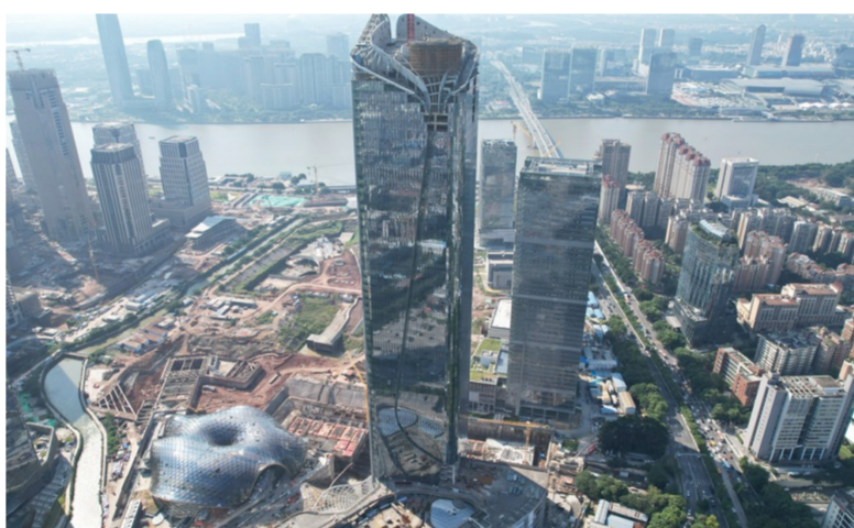
中建四局承建的广州国际金融中心项目通过主体验收，全面进入装饰装修施工阶段。项目位于广州国际金融中心起步区，总建筑面积35万平方米，是广州市在建超300米的超高层项目。项目建成后将成为广州又一集商业、零售、餐饮、影院、写字楼于一体的大型多功能商业综合体，助力打造粤港澳大湾区金融合作示范区和金融科技先行示范区。（赵必凤）
